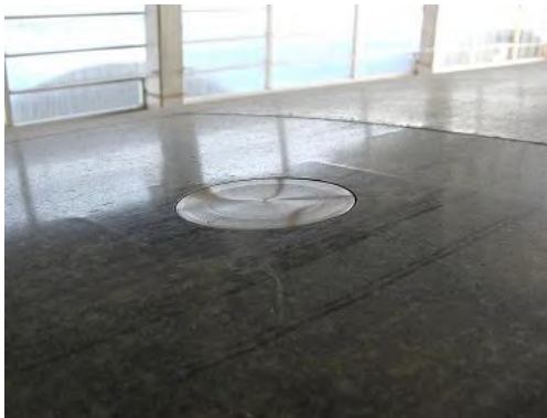
圧力センサー(型枠表面)
