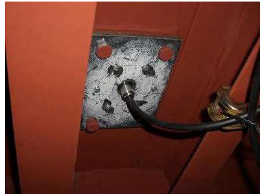
圧力センサー(型枠内側)
